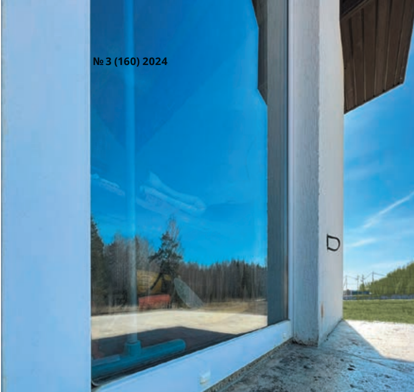
Примыкание балконной двери к бетонной плите, заполненное монтажной пеной
